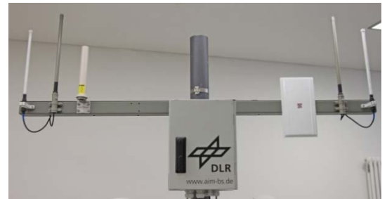
Antennenträger einer Road Side Unit
